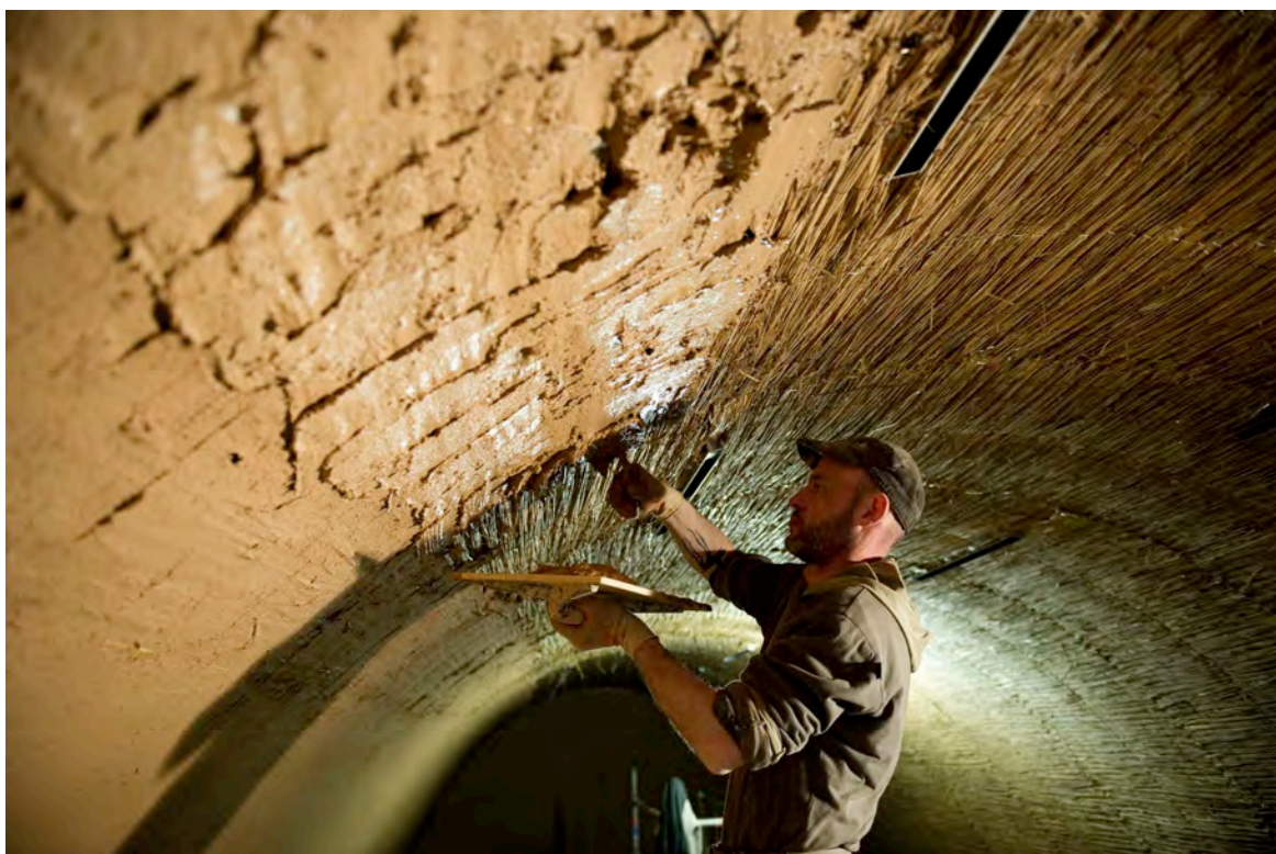
Sur les panneaux de roseaux, pose de deux couches d'enduit de terre
