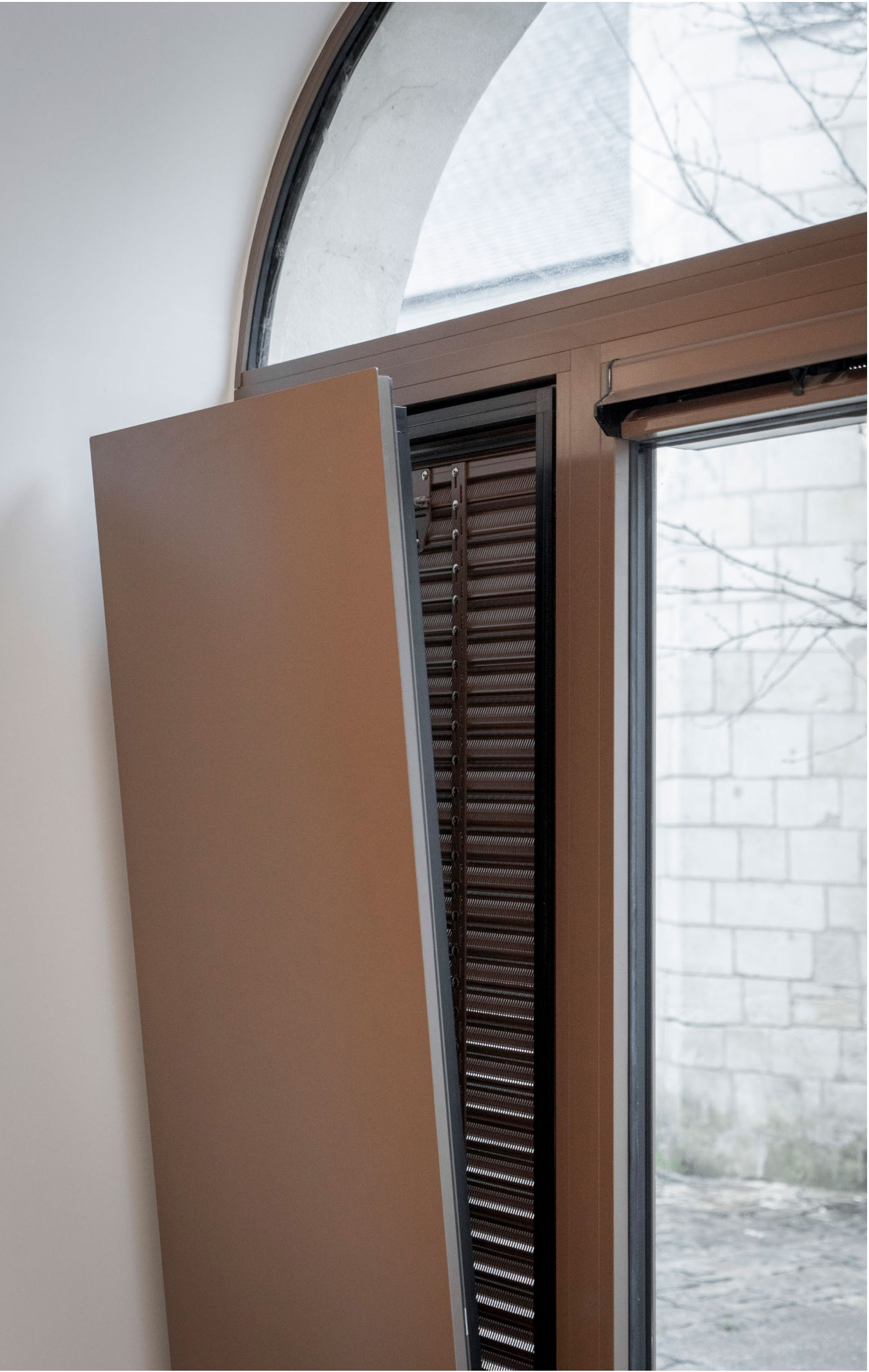
Les menuiseries à soufflet ouvertes pour le rafraîchissement naturel par débit d'air.
