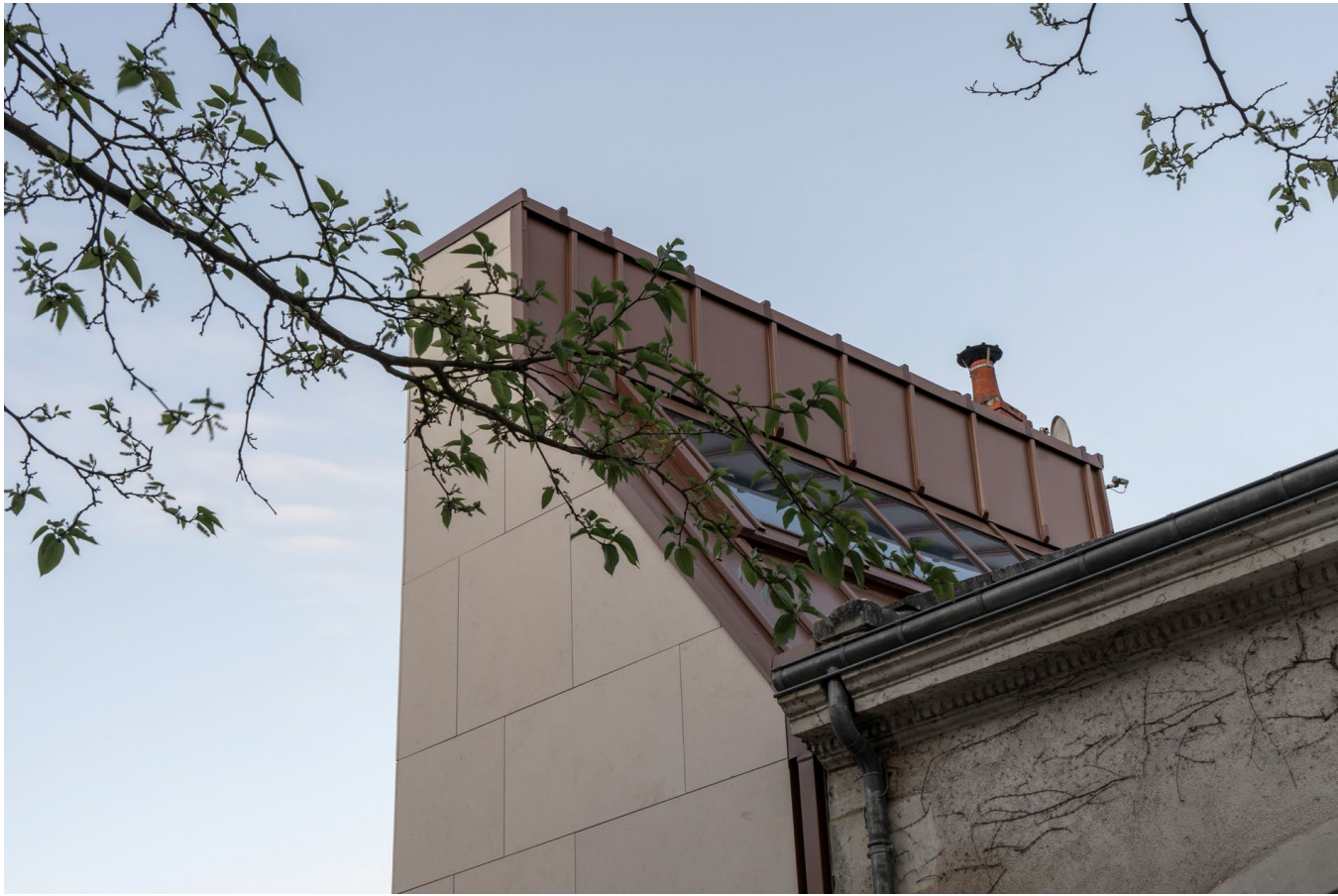
Une très large fenêtre de toit permet de chauffer le haut de la cheminée solaire.
