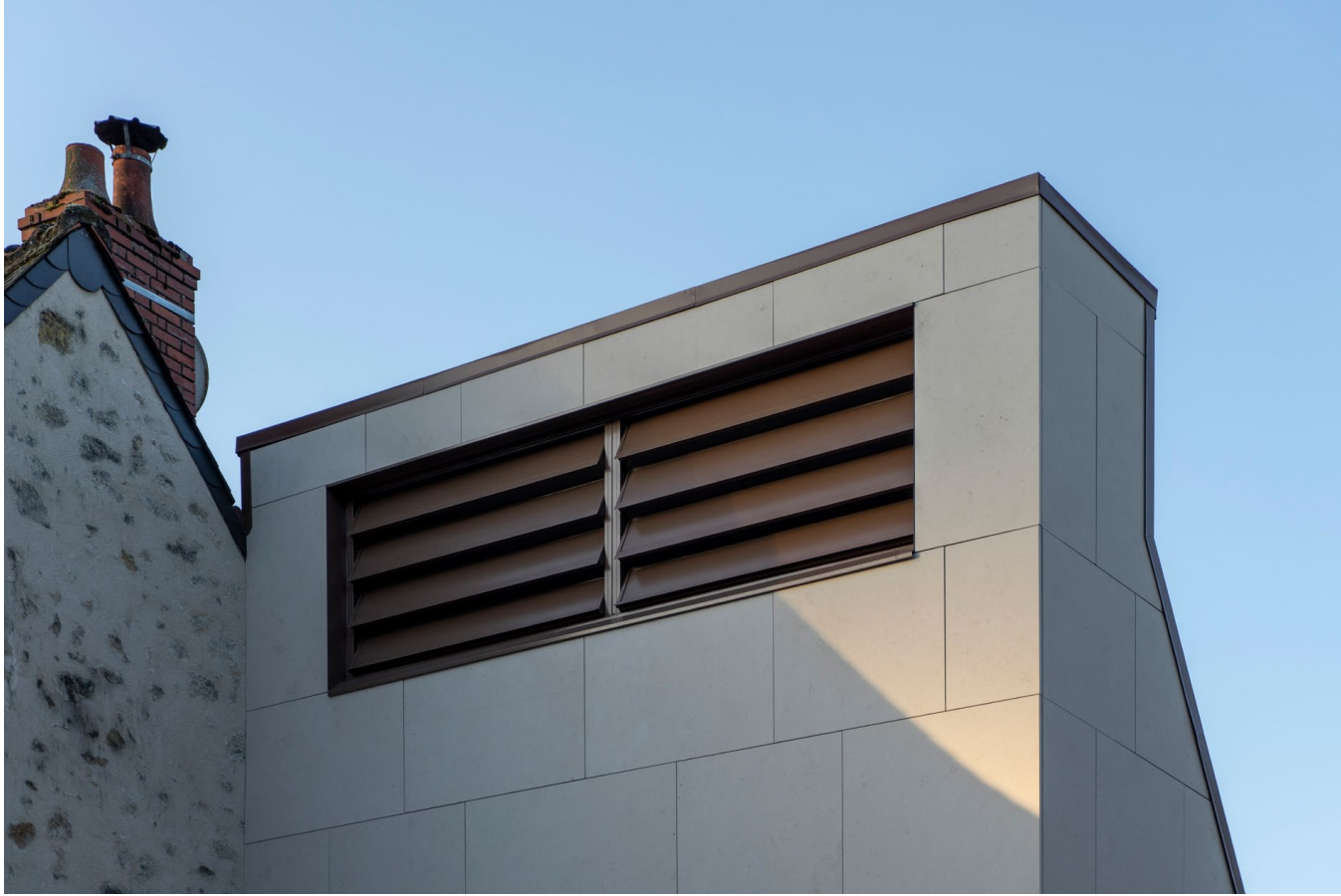
Les ventelles ouvertes au minimum au sommet de la cheminée.
