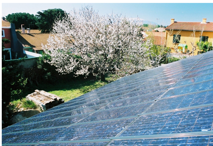
Atelier Philippe Domerue: générateur PV en toiture complète. Projet lauréat régional : « Photovoltaïque raccordé au réseau et intégré au bâti 2006 »
