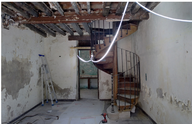
Plancher en ruine et escalier de bois après curage
